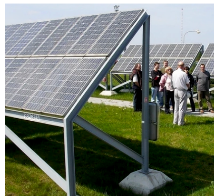
Fotovoltaická elektráreň pri jadrovej elektrárni Dukovany
