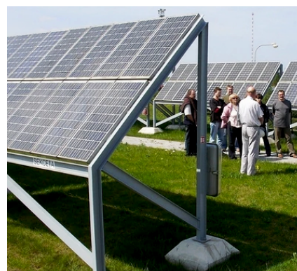
Fotovoltainká elektráreň pri jadrovej elektrárni Dukovany
