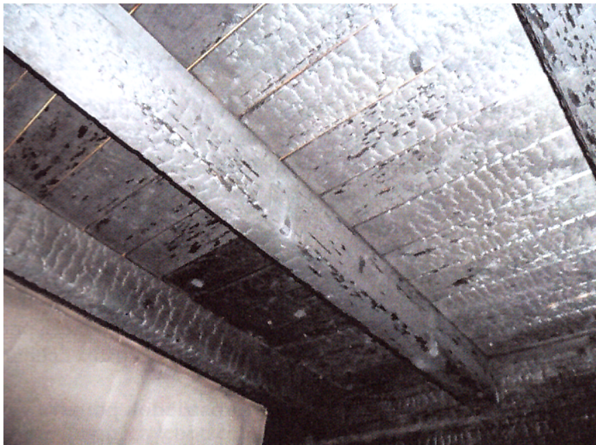
Časť drevodomu po požari
