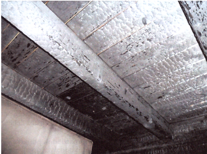
Časť drevodomu po požari
